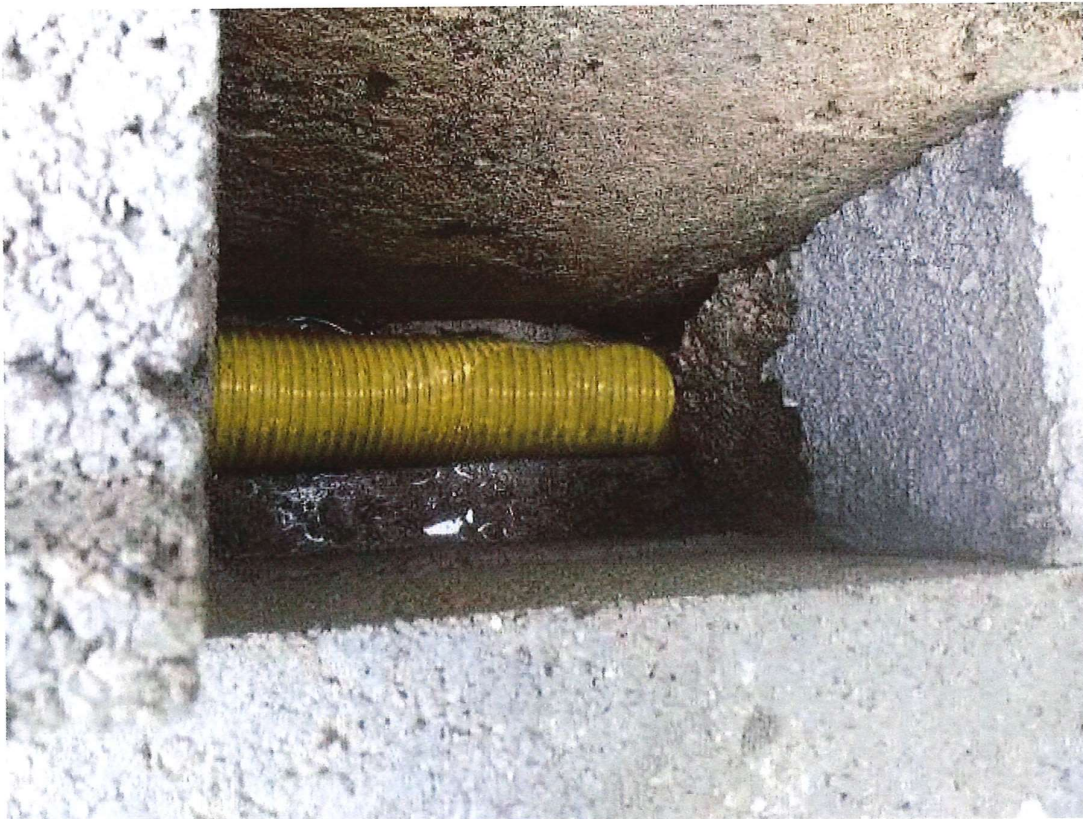
Drain de contrôle d'étanchéité au pied de la maçonnerie
